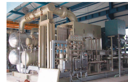
LNG BOG Compressor - Turkey 400S / 830kW
