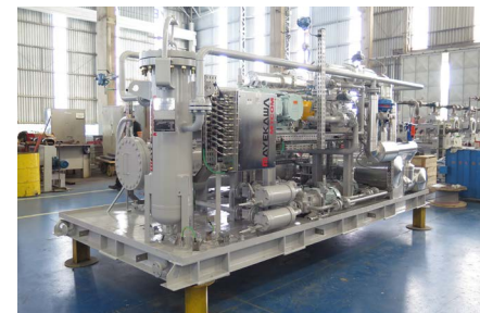
LNG BOG Compressor - Brazil
